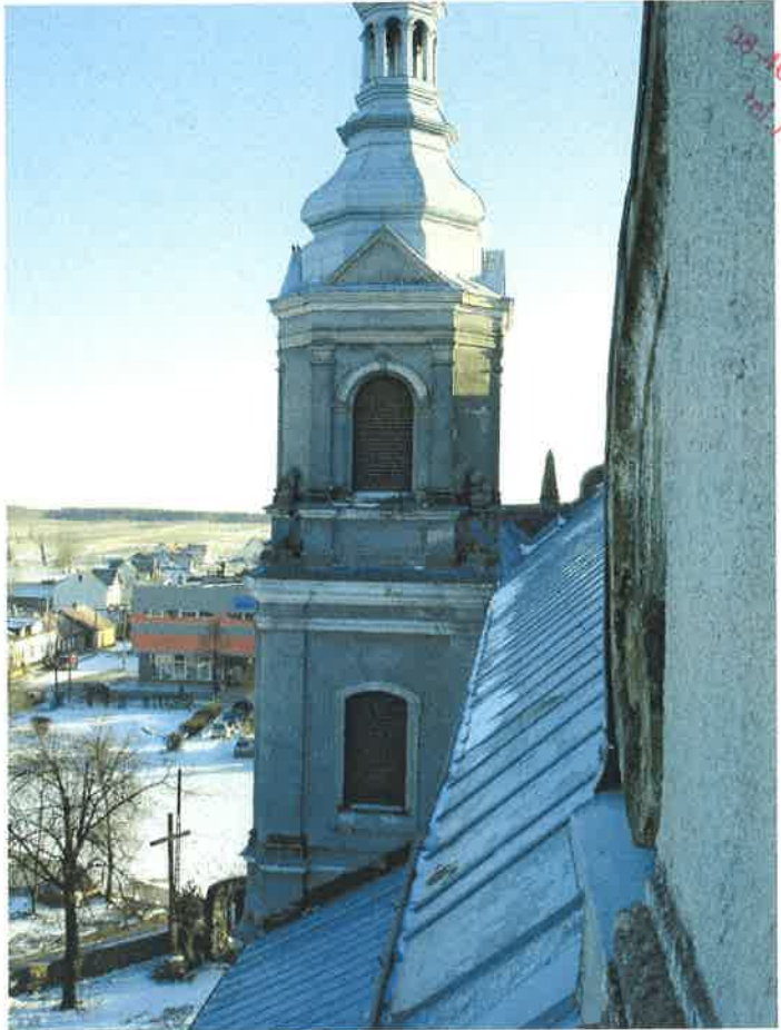
WIDOK POKRYCIA Z BLACHY OCYNKOWANEJ – SKORODOWANEJ DACH ROZSZCZELNIONY
