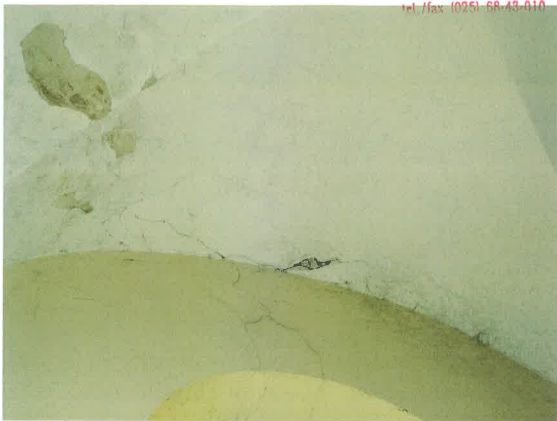
WNĘTRZE KOŚCIOŁA. WIDOCZNE ŚLADY ZAWILGOCIEŃ OD WÓD OPADOWYCH I ZARYSOWANIA NADPROŻA ŁUKOWEGO.
