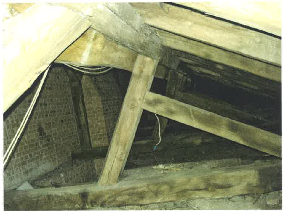
FRAGMENT WIEŻBY DACHOWEJ – ZŁY STAN TECHNICZNY, DREWNO PORĄŻONE PRZEZ OWADY I PLEŚNIE
