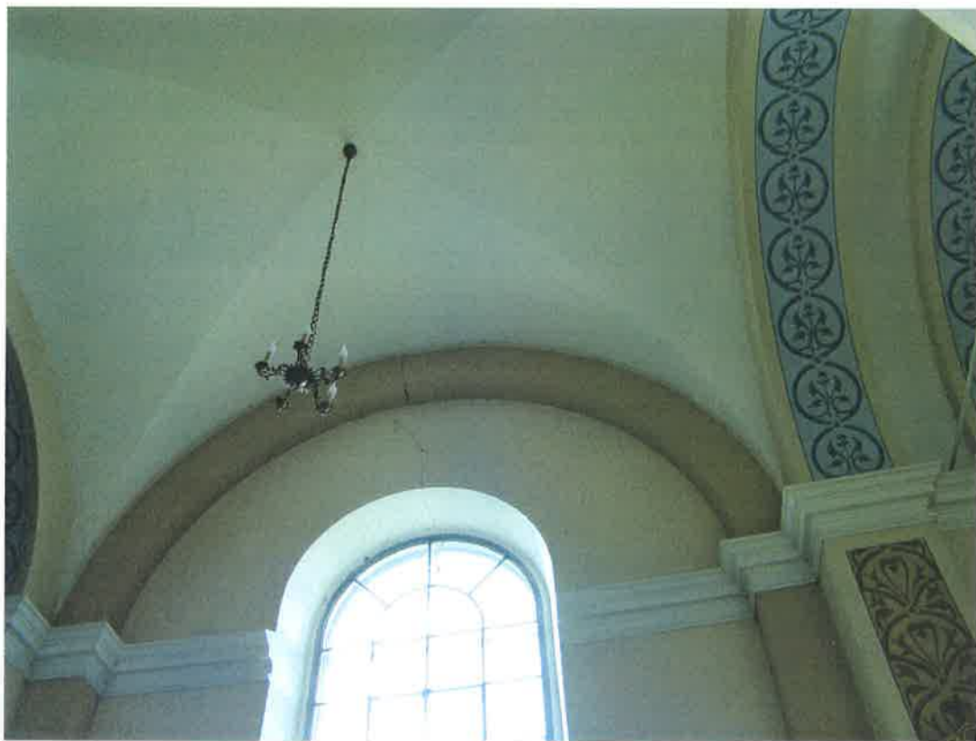
WNĘTRZE KOŚCIOŁA. WIDOCZNE ZARYSOWANIE NADPROŻA ŁUKOWEGO.
